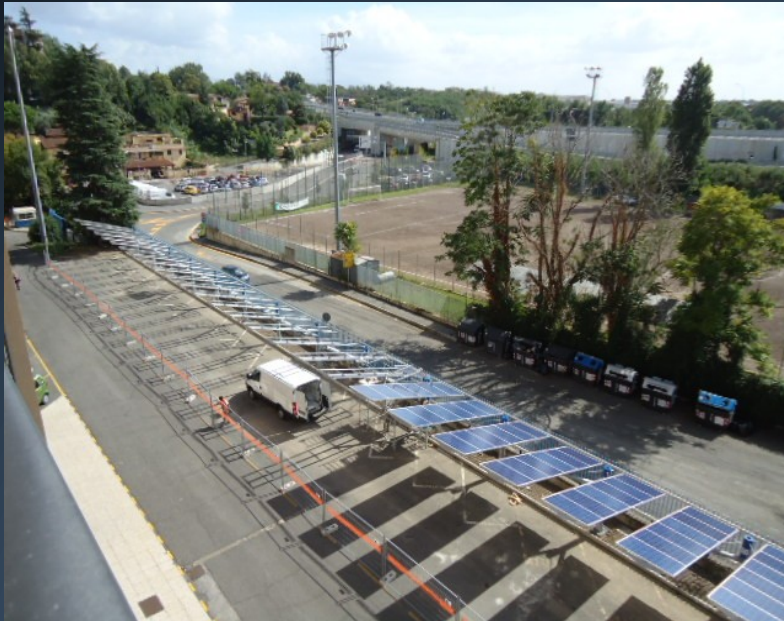
Ministero Infrastrutture e Trasporti - Impianto Fotovoltaico Via Caraci, ROMA
